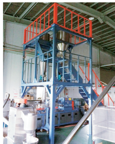
ペレット製造工程に導入された二軸押し出し機
